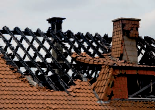
Schade aan gebouw door directe blikseminslag
