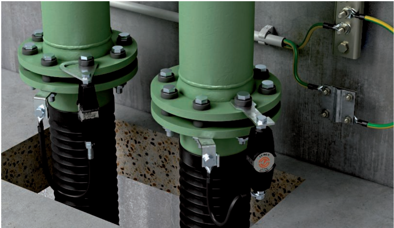
Scheidingsvonkbaan op isolatiestukken gemonteerd
