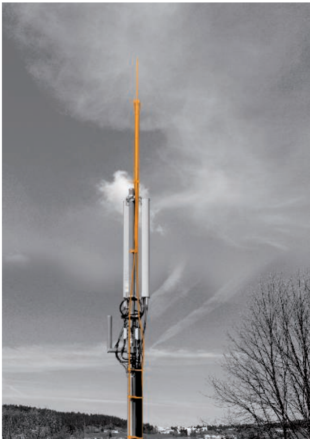
Mobiele telefoniemast met isCon®-afleiding
